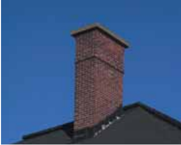
↑ Cheminée à renflement, typique de la période victorienne. Dudswell, secteur Marbleton.
